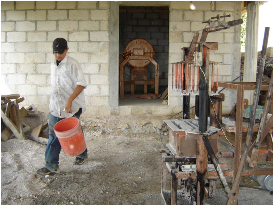
Producciones de prueba, al fondo el molino, a la derecha la bloquera
