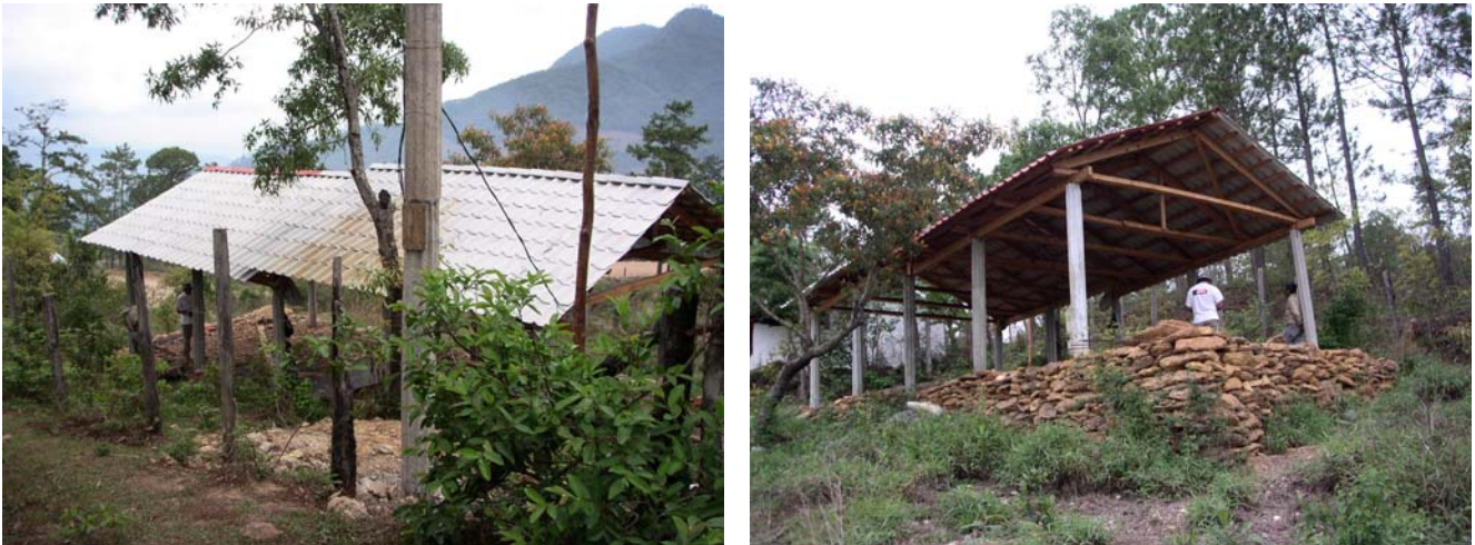
El taller a medio construir, ubicado en la orilla del camino de acceso
