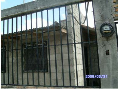
Vista general de los cambios de un techo de TMC, por plancha metálica. En 10 de las 317 viviendas construidas en proyecto Betania. Lo que representa un 3%, de la población total.
